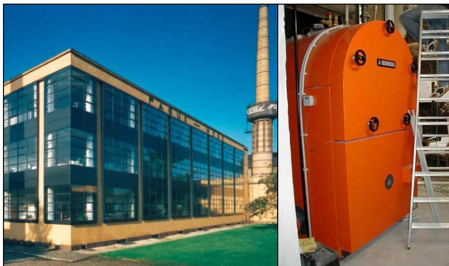
Ábra 26: Közintézményt ellátó 270 kW-os teljesen automatizált pelletkazán
